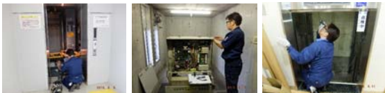
昇降機点検実施状況 機械室点検実施状況 小荷物昇降機点検実施状況
