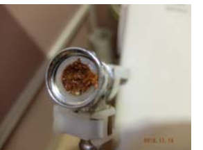
トレーニングセンター多目的トイレ給水タンクの水量が少ない修理
