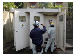
講堂奥キュービクル・図書館電気室の高圧トランスの表面温度の測定
