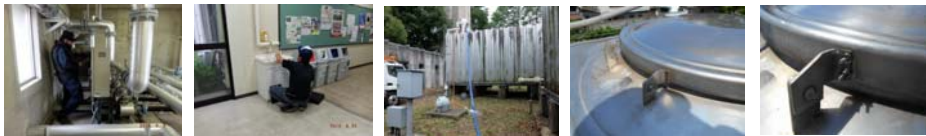
送水設備点検状況 水質検査(採水)状況 受水槽清掃状況 受水槽マンホール蓋固定金具不良状況 受水槽マンホール蓋固定金具は正完了
