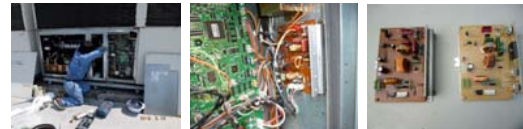
室外機点検状況 室外機基板不良状況 基板取替旧:新
